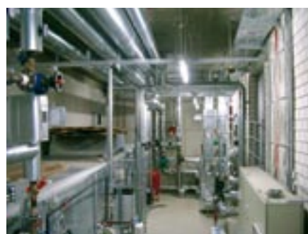
Bild 32: Lüftungszentrale im Untergeschoss des EnerGon-Gebäudes in Ulm
