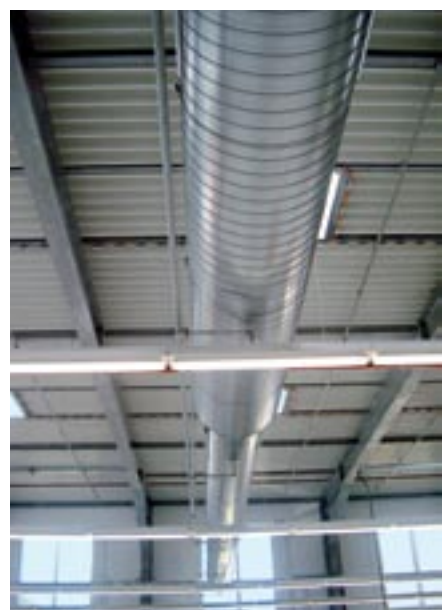
Lüftung Halle Druckerei
