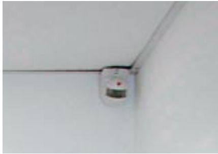
Lüftungsgerät in der Teeküche
