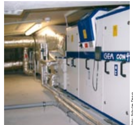
Bild 29: Lüftungszentrale für ein Gebäude mit ca. 1000 m 2 Nutzfläche
