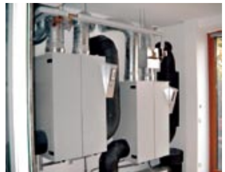
Lüftungsanlage für den Seminarbereich
