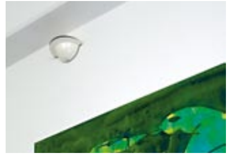
Weitwurfdüse der Lüftungsanlage
