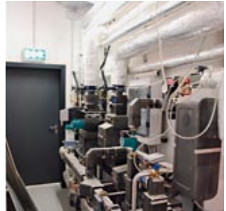
Fernwärmeübergabe für die Heizung
