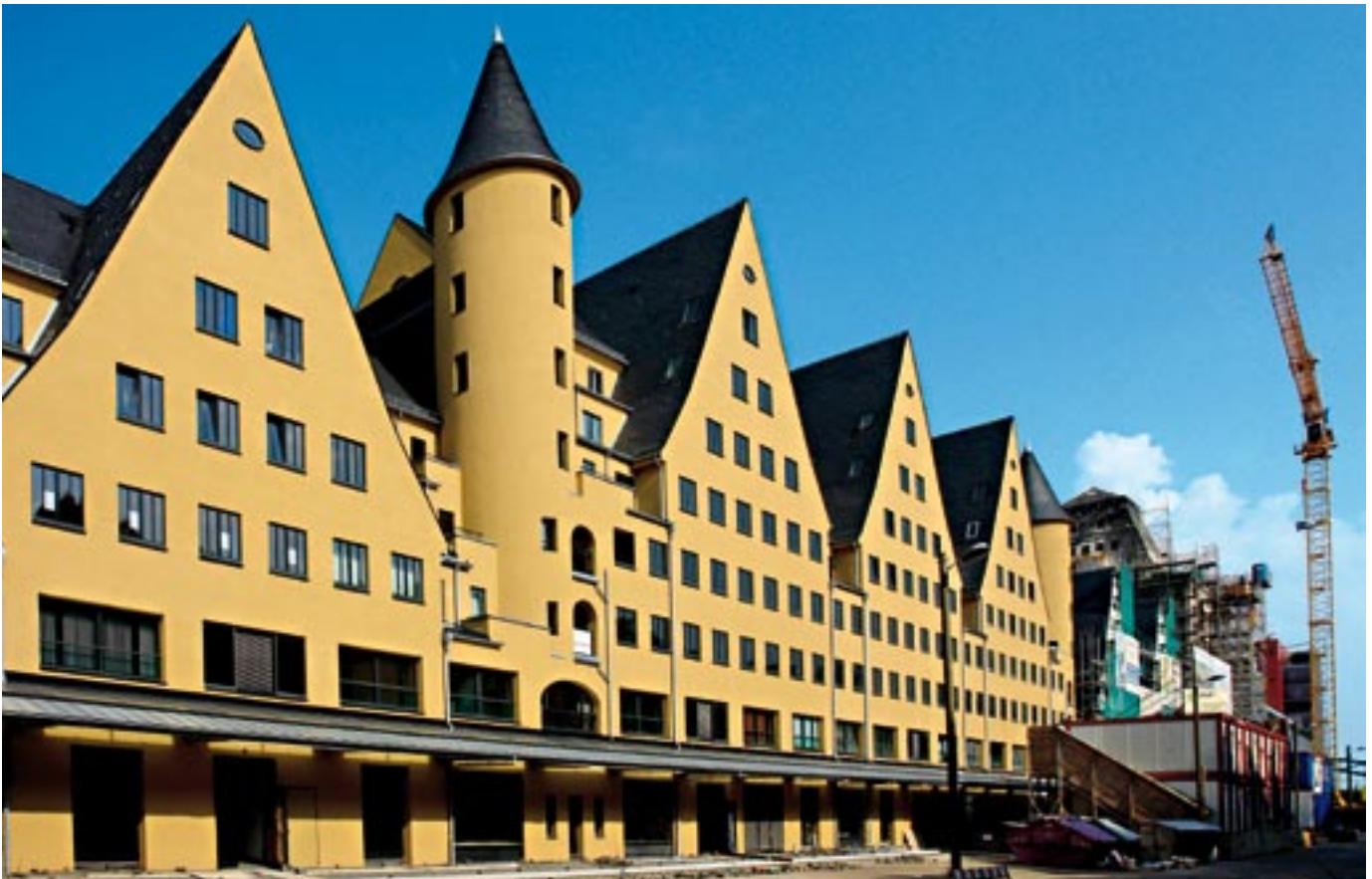
Die sieben Giebel mit den im Bau befindlichen Gebäuden inkl. „Silo“ von der Stadtseite her gesehen
