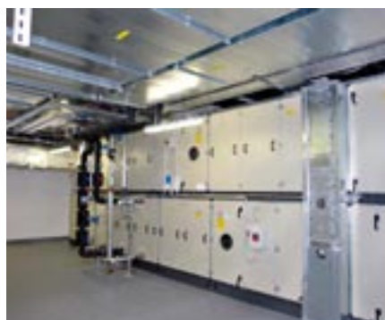
Lüftung: Zu-/Abluftanlage mit Wärmerückgewinnung für einen Teilbereich des Gebäudes
