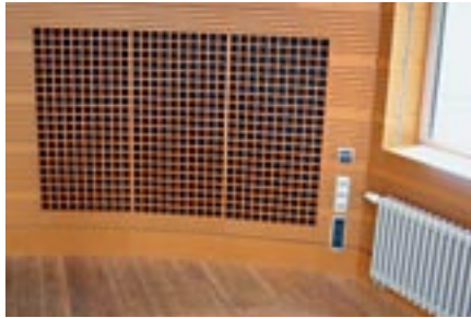
Abdeckung eines der vier Klimageräte
