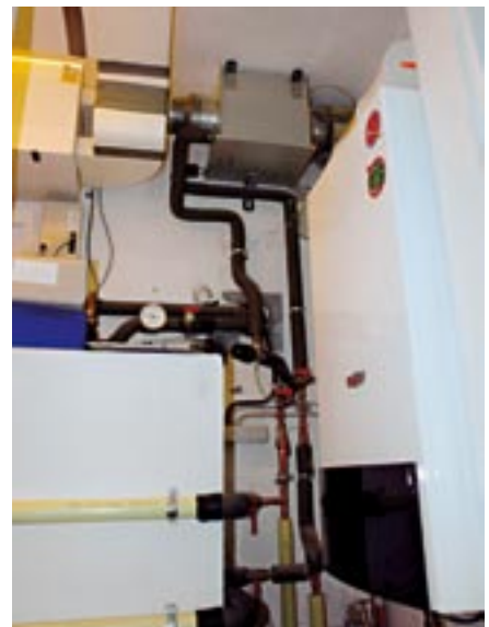
Gasbrennwertgerät im Dachgeschoss
