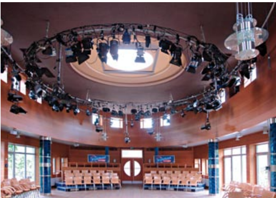
Saal mit Beleuchtungstechnik
