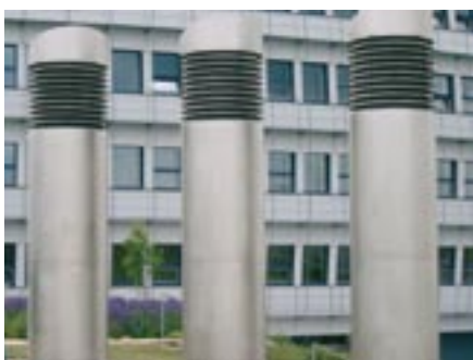
Bild 31: Ansaugung der frischen Außenluft
