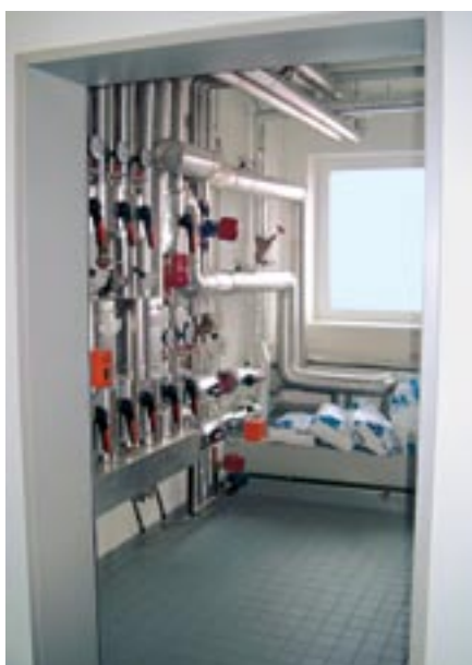
Hausanschlussraum und Heizungsverteilung
